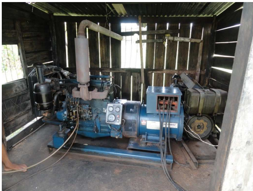
Figura 25 - Gerador elétrico da Vila.
